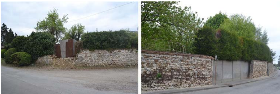
Illustration 6: Murs ancien en mauvais état
